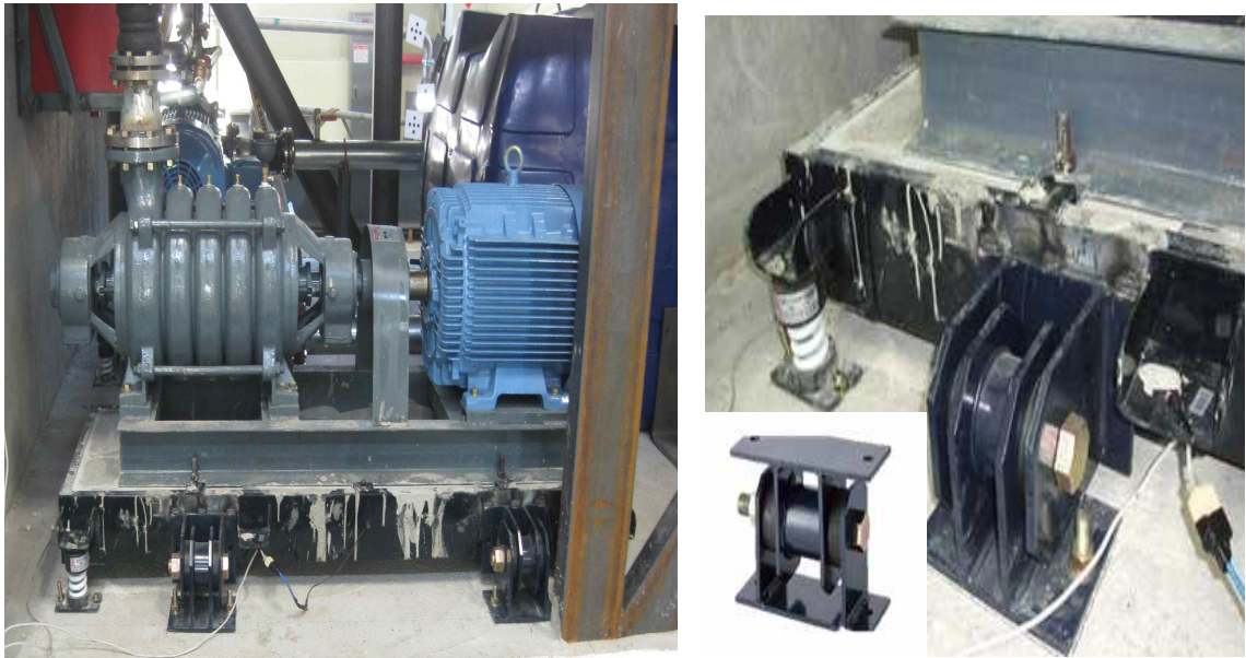
이동방지형 내진 스토퍼 설치 사례
